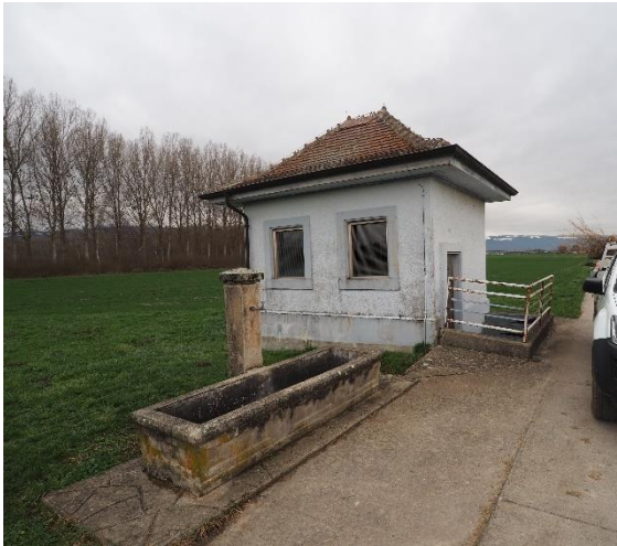
Station de pompage des Planches de l'Isle
